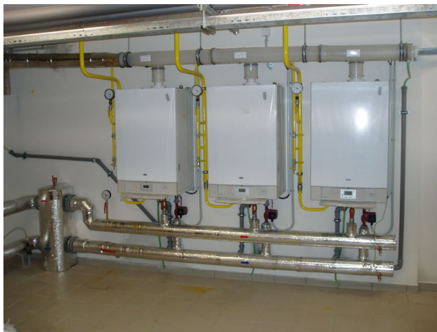
Obrázek 2.2.: Pohled na kotelnu s třemi plynovými kotli v kaskádním zapojení, převzato z [12]
